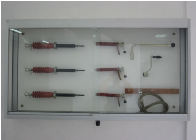
33kV S/S (GIS)
